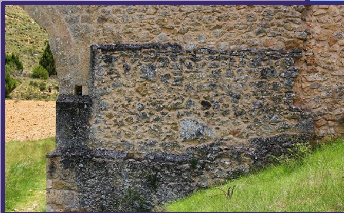
Diferentes lienzos de mampostería. Hasta cuatro en disminución por secciones conforman el muro desde la base y el límite superior para la conducción del agua.
